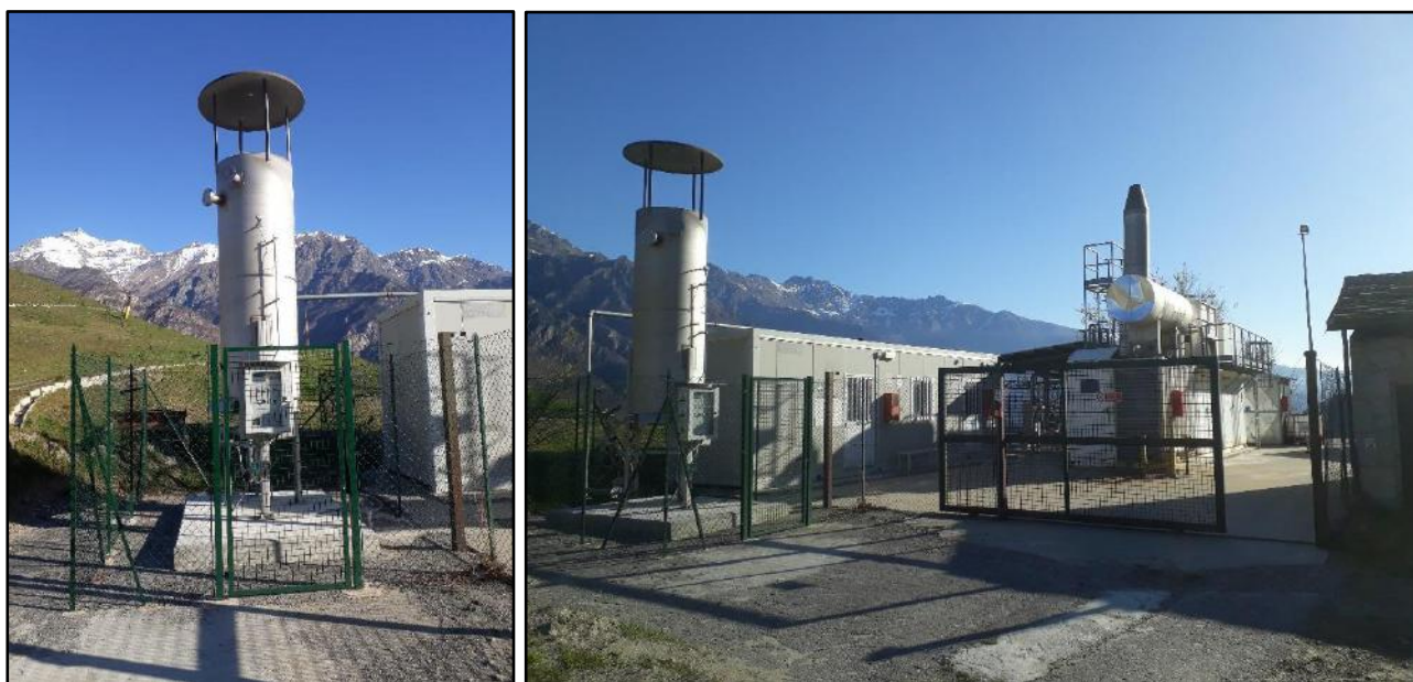
Fig 6: nuova torcia installata a servizio del lotto 3
