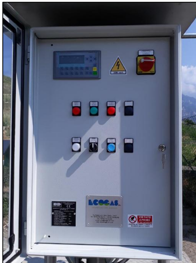
Fig 7: quadro di comando torcia a servizio del Lotto 3
