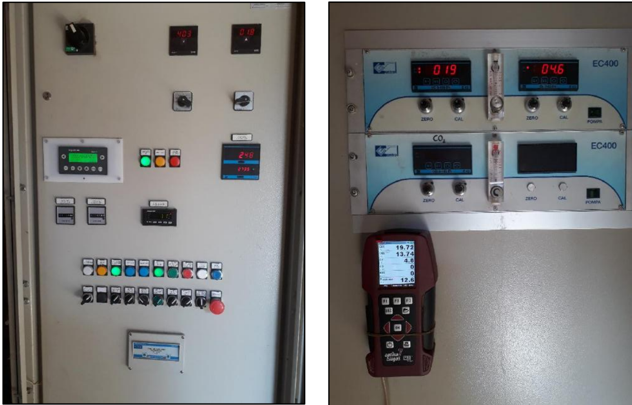
Fig 2: Quadro controllo e quadro analisi torcia a servizio dei Lotti 1 e 2.
