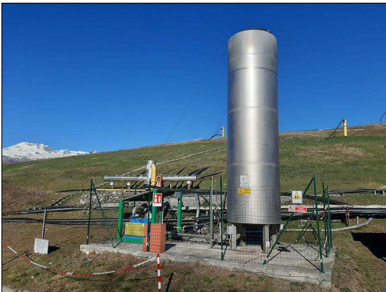
Fig 1: Torcia di combustione biogas Lotto 2.
