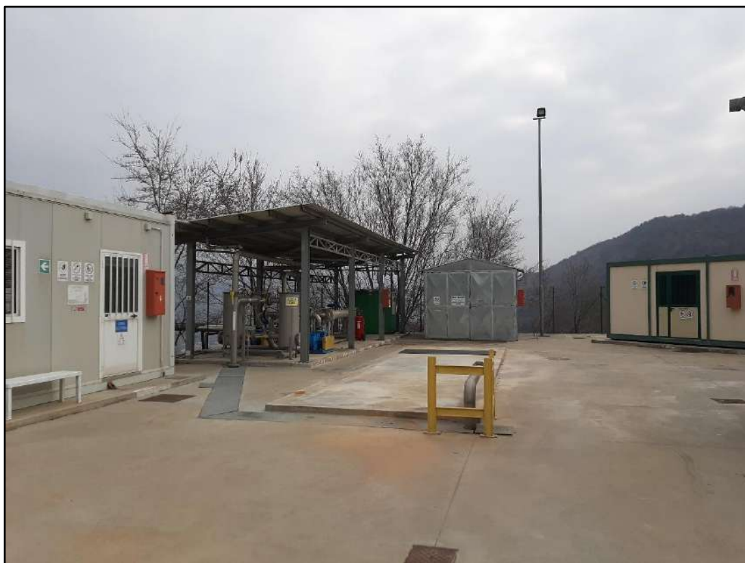
Fig 7: foto dell'area di aspirazione del biogas a seguito della rimozione del motore
