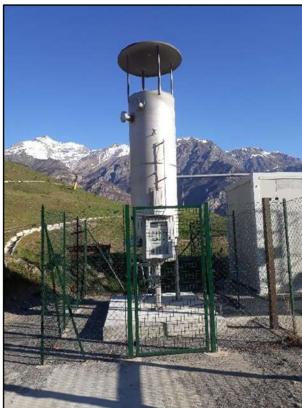
Fig 6: Tabella dati riassuntiva e foto della torcia installata a servizio del lotto 3
