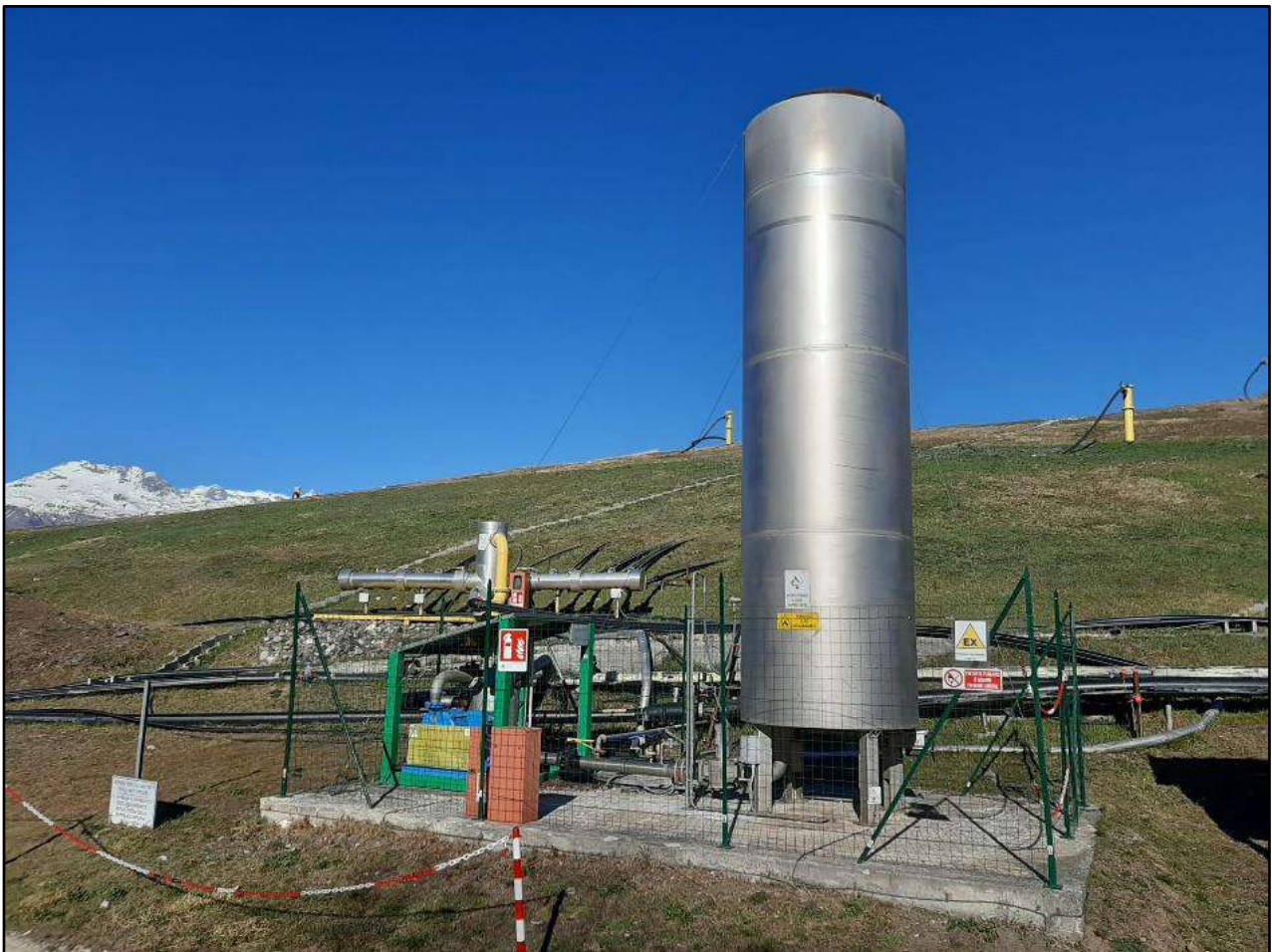
Fig 1: Torcia di combustione biogas Lotto 2.
