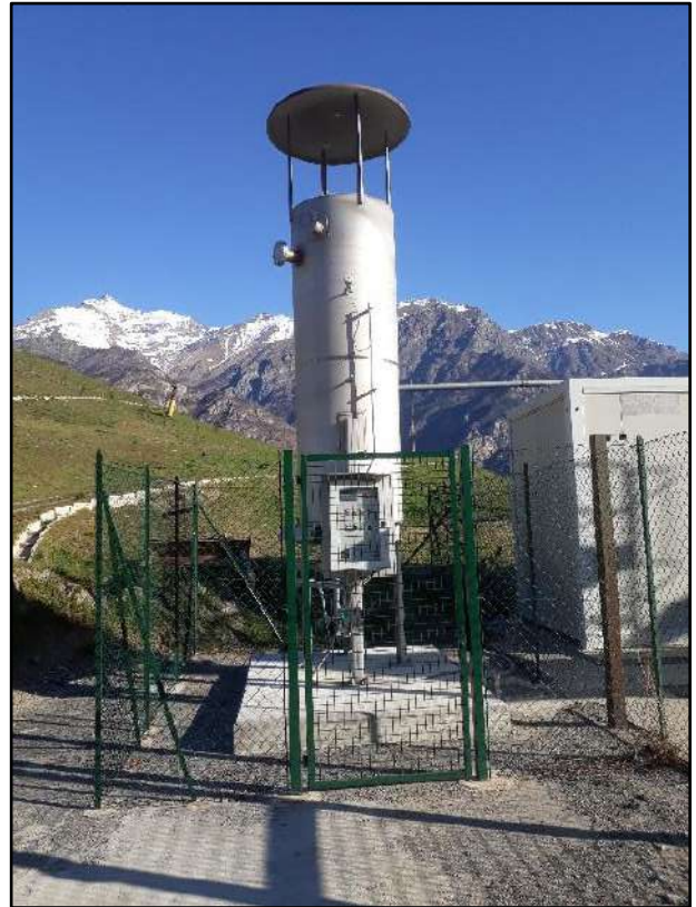
Fig 6: Tabella dati riassuntiva e foto della torcia installata a servizio del lotto 3
