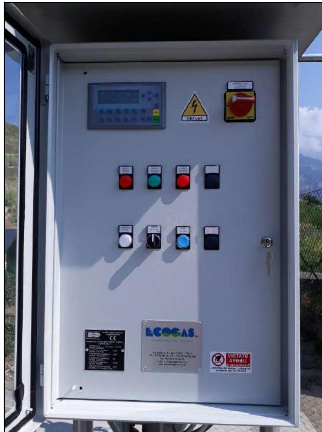
Fig 8: quadro di comando torcia a servizio del Lotto 3
