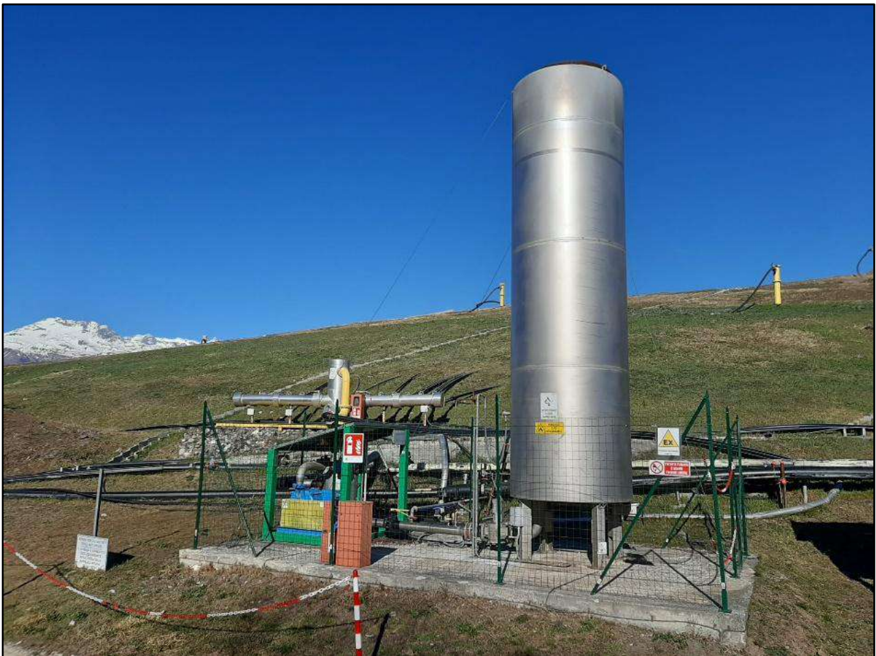
Fig 1: Torcia di combustione biogas Lotto 2.
