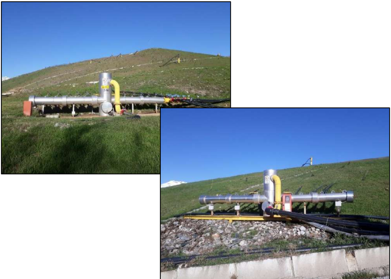
Fig 10: stazioni di regolazione SST 1 (sopra) es SST 2 (sotto)
